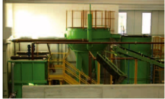
Depuratore Chimico fisico, sedimentatore e stoccaggio
